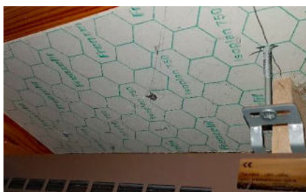
Heizung mit Dämmung (Sakristei)
