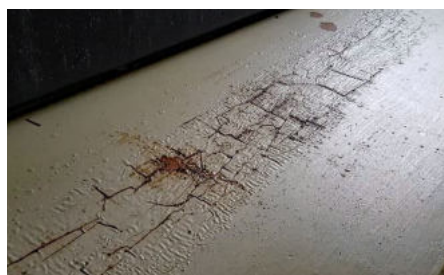
Schäden an den Bänken im Kirchenschiff
