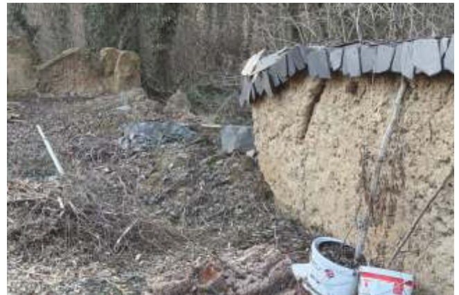
Die desolante Lehm-mauer, die dringend Hilfe bedarf...
